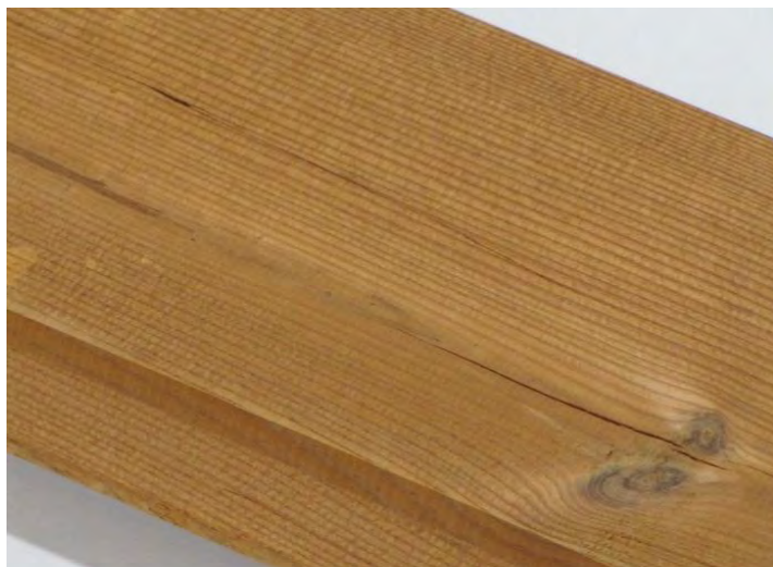
Trhlina na lícni straně do délky 200 mm po výrobě povoleny.
